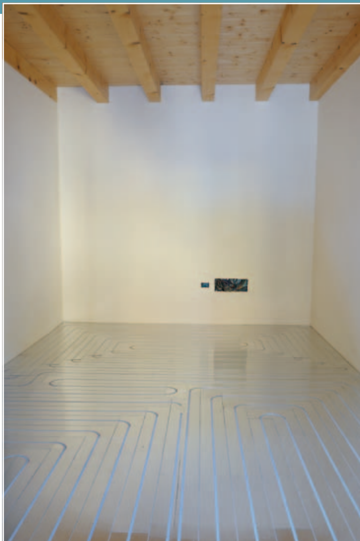
Ambientazione con impianto "FIDE" installato dove si possono notare i vari circuiti.
